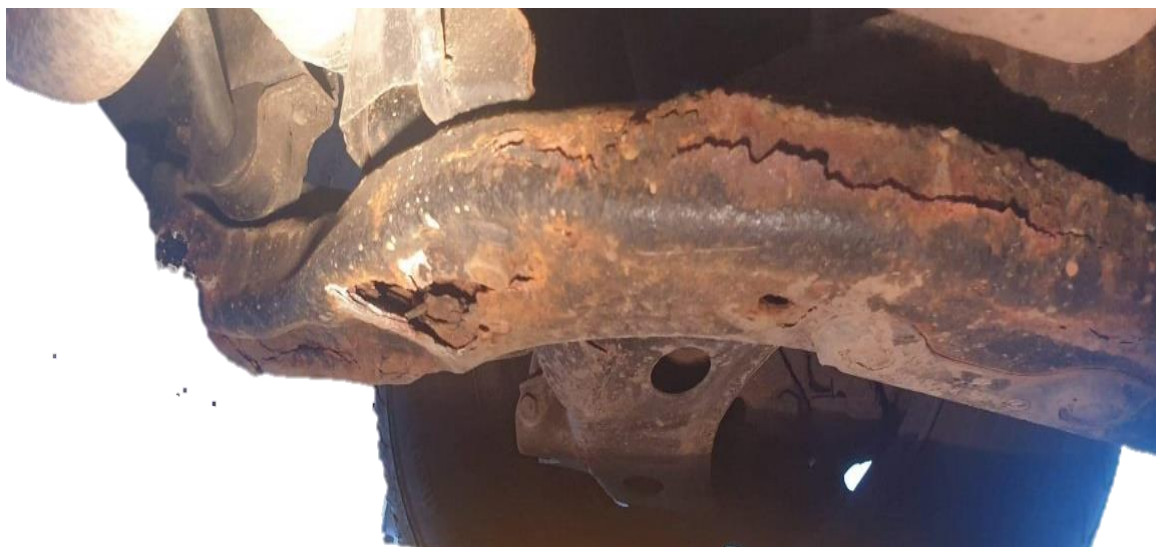
Rysunek 4.7. Ślady korozji belki przedniego zawieszenia. Źródło: opracowanie własne.
